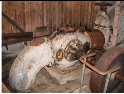
Nottveit gamle turbin 28 kW
