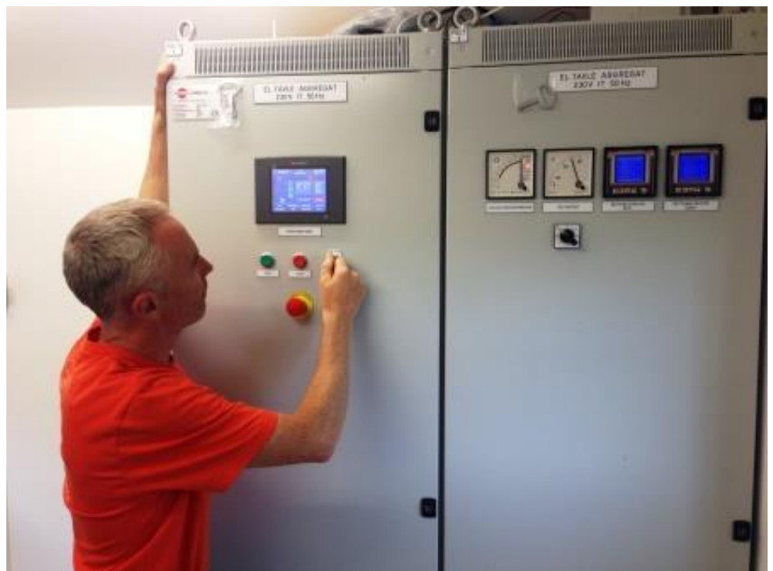
Kontrolltavle og brytertavle
