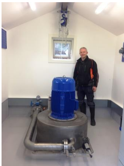
Pelton turbin med asynkron generator fra Richard Vanvik
