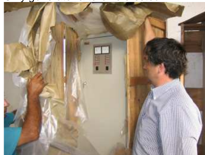
Inspection og cubicles
